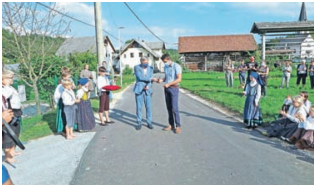
Eden od obnovljenih delov vodovoda in posledično ceste je tudi odsek mimo Podružnične šole Ovsiše, kjer so v četrtek pripravili priložnostno slovesnost ob zaključku projekta. Trak sta prerezala radovljiški župan Ciril Globočnik in predsednik sveta KS Podnart Nejc Šter.
