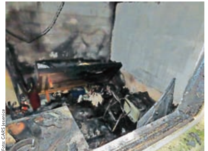
Soba, v kateri je izbruhnil požar, je povsem uničena.
