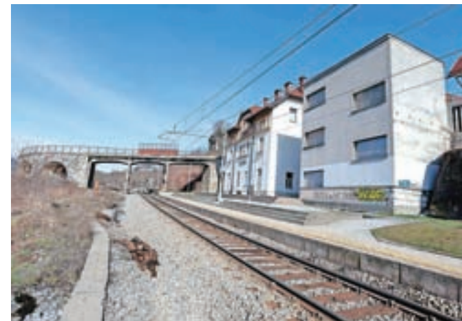
Vlada meni, da je nadgradnja na odseku med Kranjem in Lescami zaradi slabega stanja proge in nosilnih konstrukcij, zastarelih signalnovarnostnih naprav in nezavarovanih nivojskih prehodov treba izvesti prednostno. / Foto: Tina Dokl
