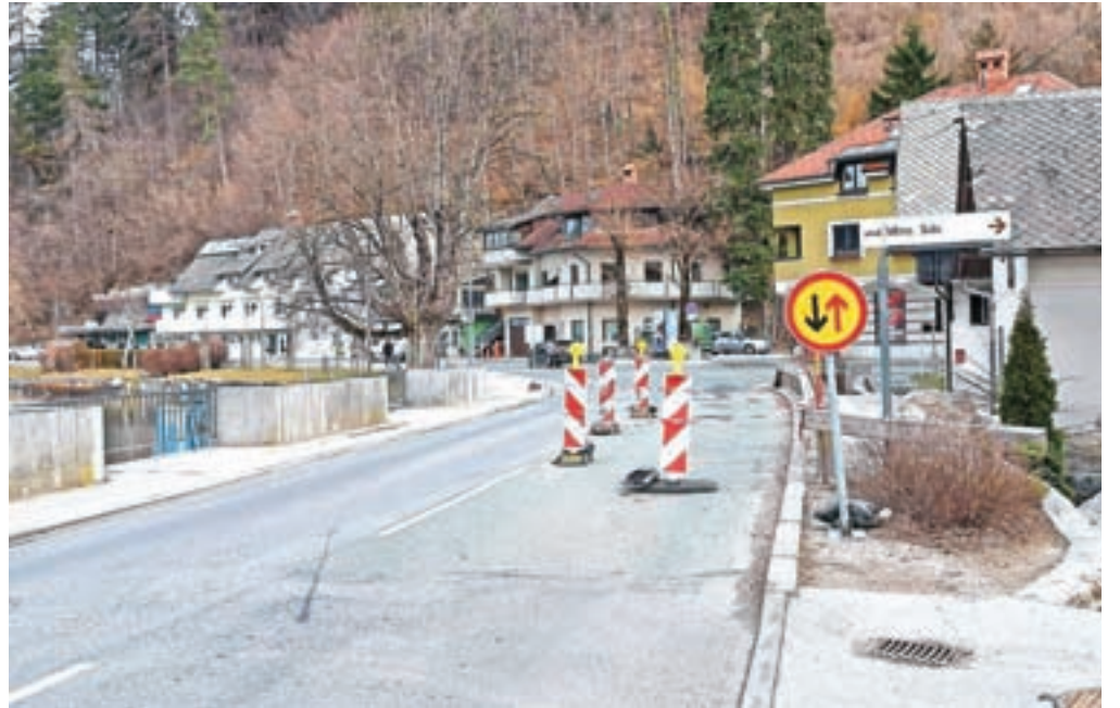
Na mostu na Mlinem so uvedli začasne ukrepe za omejitev prometa. / Foto: arhiv občine
