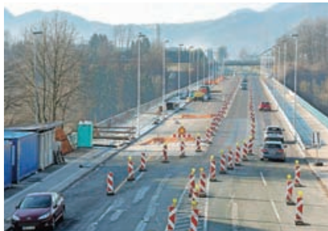
Prenova Delavskega mostu v Kranju bo očitno trajala vsaj do poletja. / Foto: Tina Dokl
