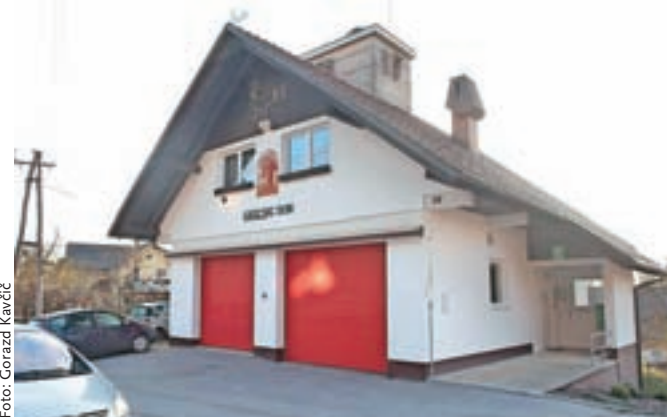
Gradbena inšpektorica je sredi novembra zaprla gasilski dom v Zasipu, ker objekt nima uporabnega dovoljenja.
