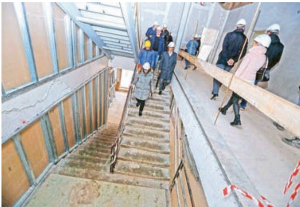
Prenovo šole si je ogledal tudi kranjski župan Matjaž Rakovec s sodelavci in izvedel, da dela potekajo po terminskem načrtu. / Foto: Tina Dokl
