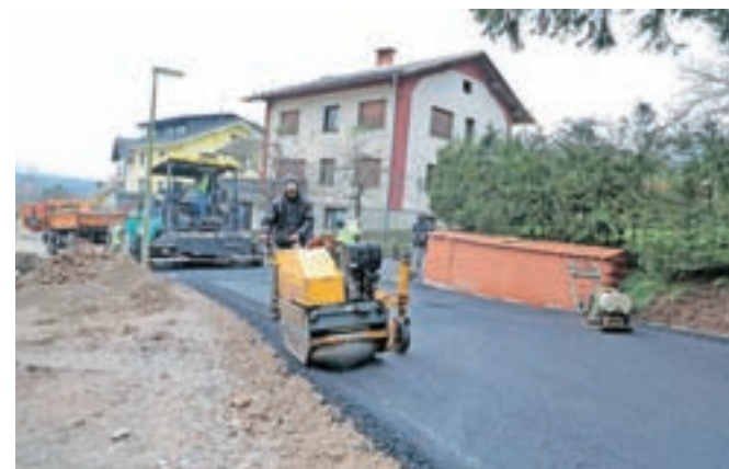
Z asfaltiranjem ceste proti Možjanci so končali drugo fazo gradnje kanalizacije v Tupaličah. / Foto: Tina Dokl
