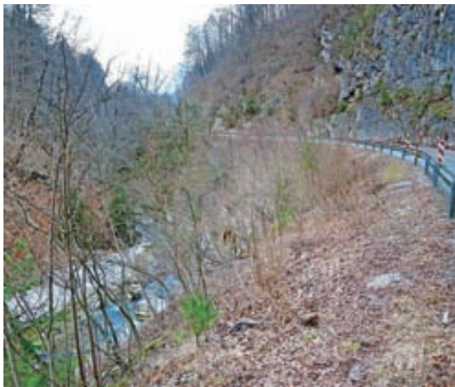
Reka je že spodkopala večji del opornega zidu, zato bo treba postaviti novega.
