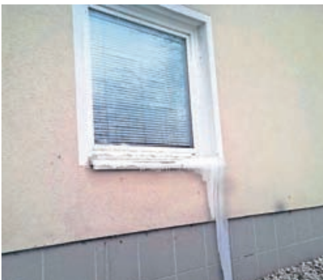
Led in voda sta uničila dovršen del stavbe, zamrznjena je bila tudi zunanost objekta. / Foto: arhiv PGD Naklo
