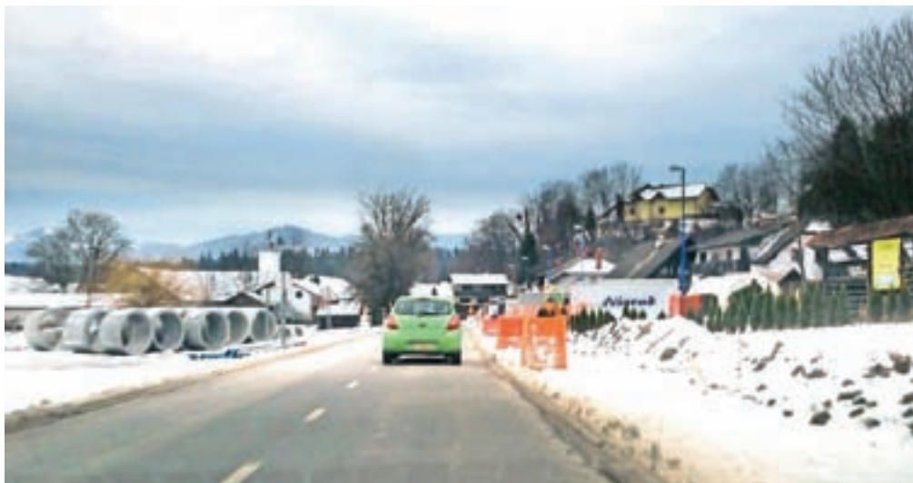
Rekonstrukcija ceste v Zbiljah se je začela konec lanskega leta. Kot trenutno kaže, bo za pridobitev vseh potrebnih zemljišč potrebna tudi razlastitev.
