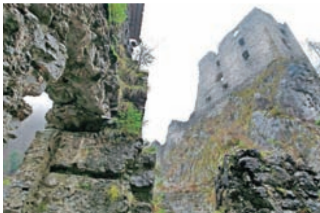
Občina Radovljica bo še letos izvedla najnujnejšo sanacijo propadajočega gradu Kamen nad Begunjami. / Foto: Gorazd Kavčič
