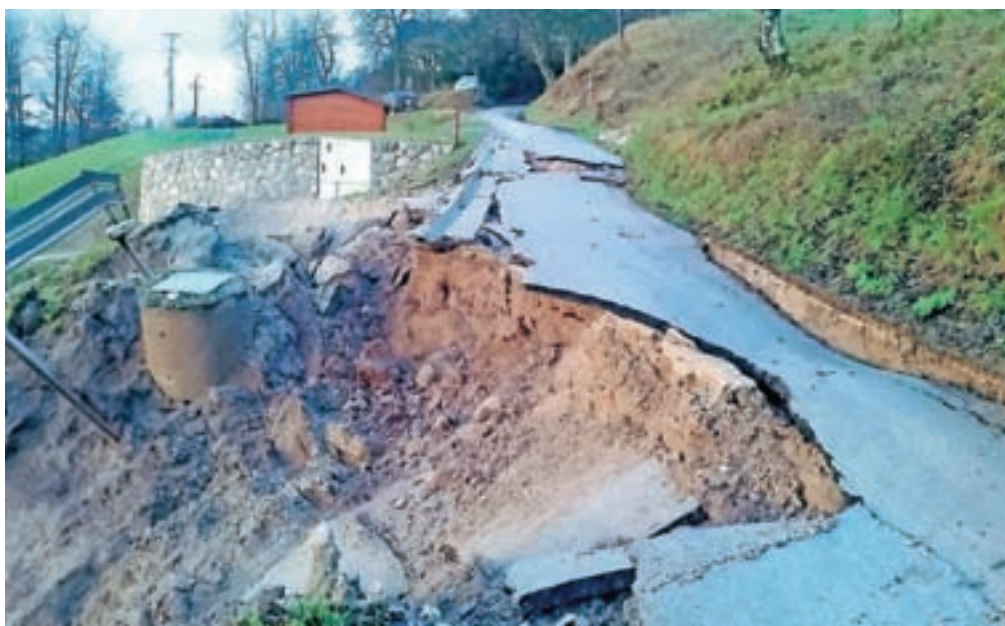
Pred naseljem Javornik se je sprožil zemeljski plaz in poškodoval del ceste in vodovod.
