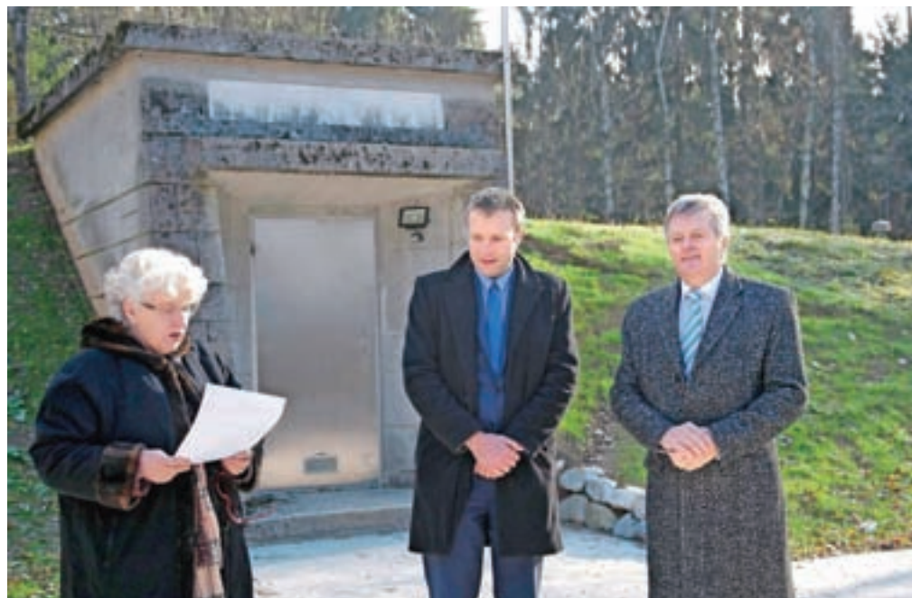
V sklopu projekta so popolnoma obnovili vodohran Ledevnica, ki so ga opremili s sodobno UV-dezinfekcijo, sta na predstavitvi projekta v torek povedala direktor Komunale Radovljica Matija Žiberna in radovljiški župan Ciril Globočnik. / Foto: Gorazd Kavčič
