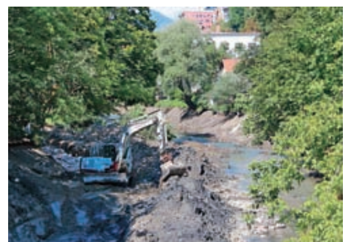
Stanje v izpraznjenem kanalu v času vzdrževalnih in sanacijskih del daje vtis neurejenosti tudi zaradi izpustov kanalizacij in meteornih voda, na kar pa Gorenjske elektrarne nimajo vpliva.
