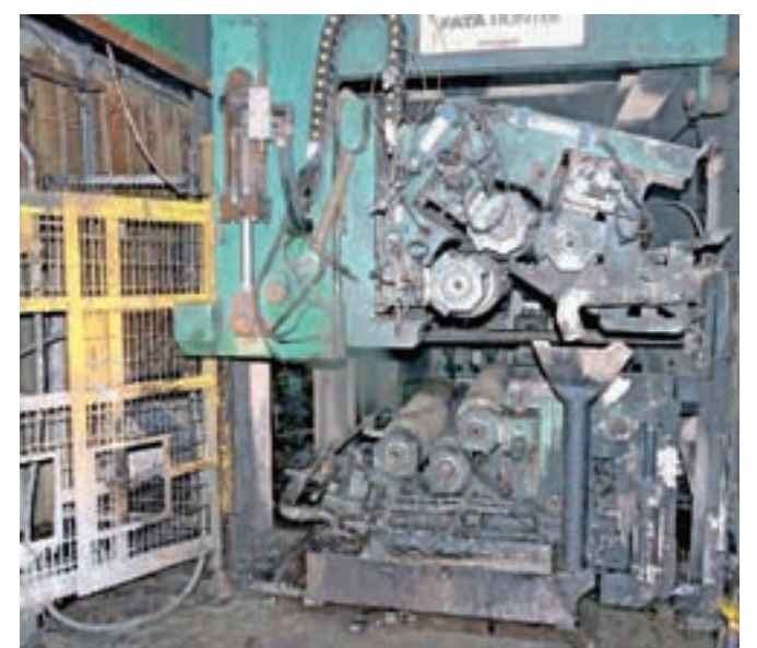
Do eksplozije v peči za žarjenje pločevine je prišlo med vzdrževalnimi deli. / Foto: GARS Jesenice
