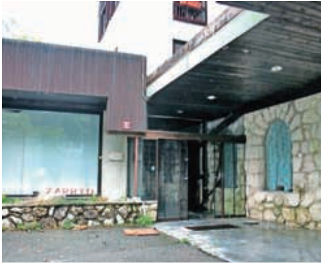
Vrata Hotela Zlatorog so odprta, stekla razbita, leseni opaž odpada.
