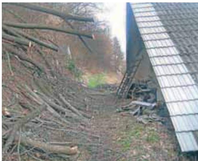
Drevje je poškodovalo tudi streho Tratnikove hiše v Žireh.
