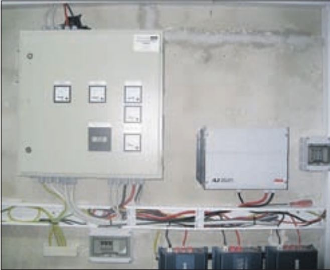
Planinska koča ima v celoti obnovljeno električno napeljavo, sončne celice in vetrni agregat, kar zagotavlja več energije, ki je okolju še bolj prijazna. | FOTO: ARHIV PD KAMNIK
