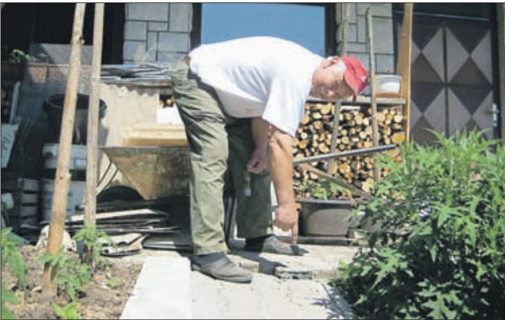
Janez Šega kaže, kako veliko razpoko na vrtu je povzročilo plazenje zemlje ob gradnji športnega igrišča na Sovodnju.
