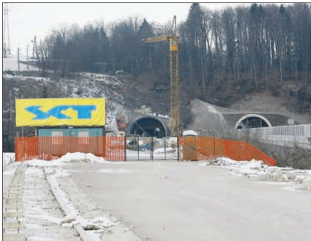
SCT v Sloveniji trenutno izvaja dela na 64 gradbiščih, veliko jih je tudi na Gorenjskem. Vendar delo v teh dneh, menda tudi zaradi nizkih temperatur, večinoma stoji. Številni se sprašujejo, ali ni glavni razlog insolventnost in nelikvidnost podjetja. / Foto: Gorazd Kavčič
