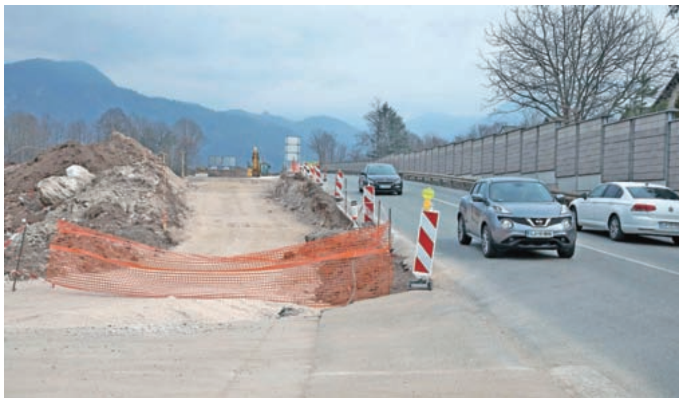
Cesta od krožišča z avtoceste pri Lescah proti semaforiziranemu križišču za Bled je ponovno gradbišče, urejajo štiripasovnico. Pred dobrim letom dni zgrajeno protihrupno ograjo pa bodo podrli, jo povišali in ponovno postavili. / FOTO: GORAZD KAVČIČ
