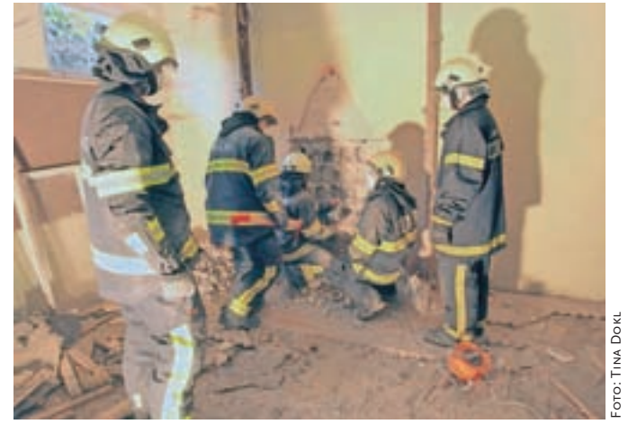
Do ponesrečencev v poškodovanih stavbah so se reševalci prebijali tudi z napornim kopanjem odprtín v stenah.
