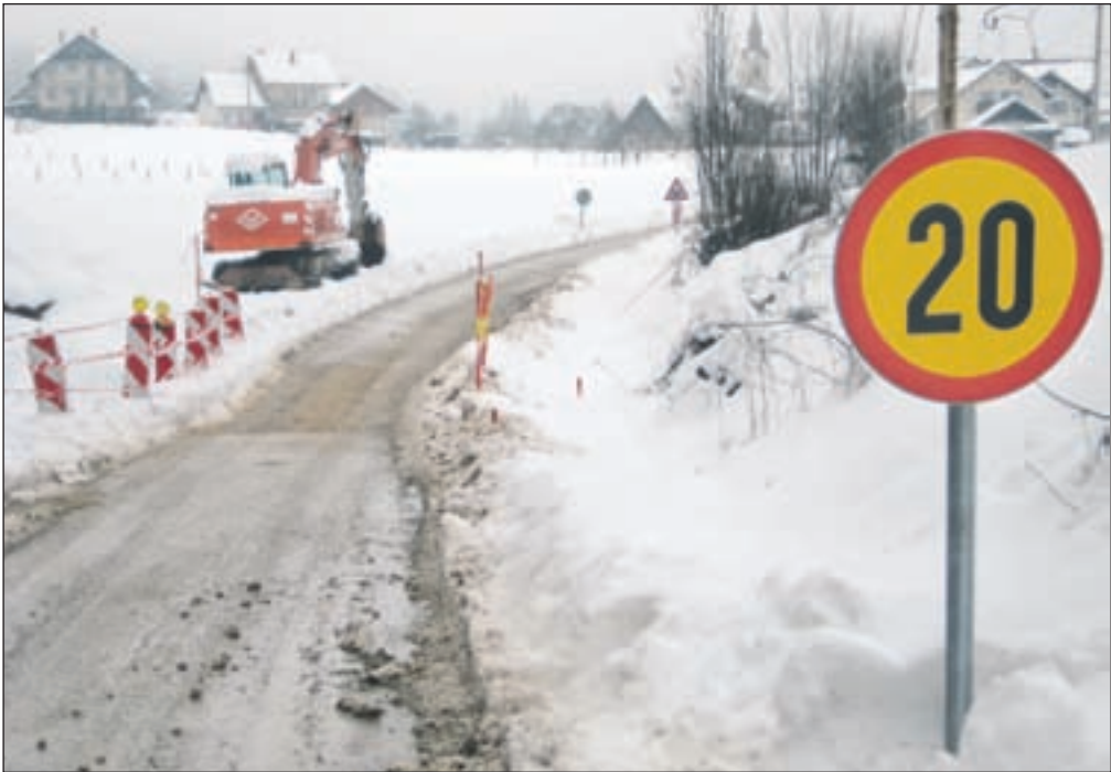
Cesta Posavec-Podnart je zaenkrat prevozna, promet je omejen na hitrost 20 kilometrov na uro. Intervencijska sanacija bo opravljena spomladi.
