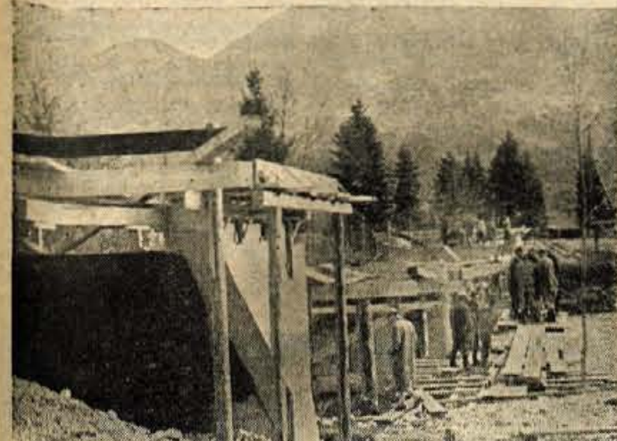
Tudi sedanje delo na mostu čez Savo Bohinjko, tik pred Bistrico, sodi v sklop mnogih novih objektov, preurejenih in asfaltiranih cest v bohinjskem kotu.
