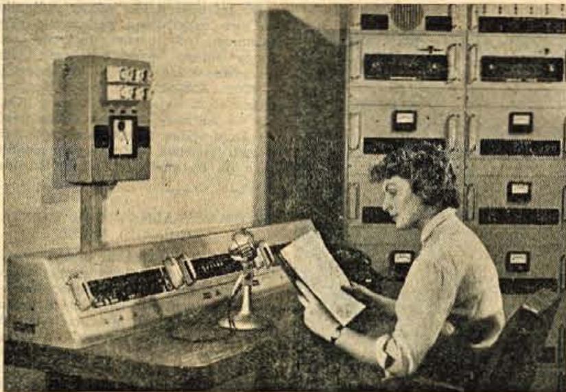
Mešalna miza in ojačevalna naprava 400 W montirana v Ljudski skupščini LRS
