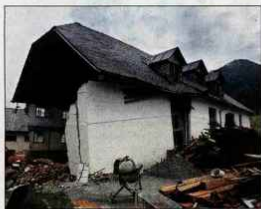
Medtem ko so bili delavci na malici, se je zrušila zunanja stena zadružnega doma v Sorici. / Foto: Tina Dokl
