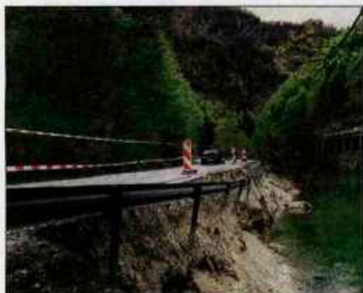
V Bohinju je prednostna naloga obnova ceste skozi Sotesko. /Foto: Petra Lotrič
