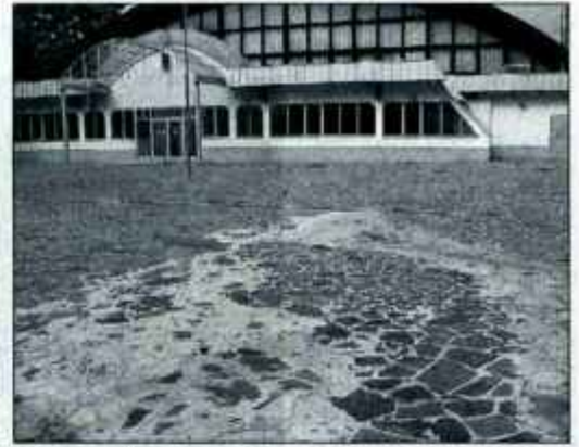
Slabo opravljeno delo - kamniti tlak pred športno dvorano poka in odstopa od podlage, streha na dvorani pa zamaka.
