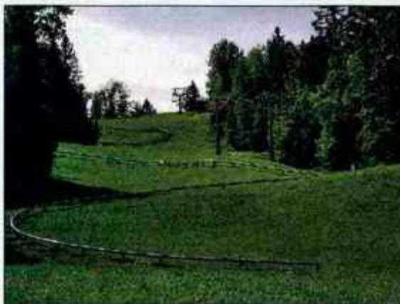
Na Straži so že namestili kovinsko ogrodje za sankališče, ki bo začelo delovati 1. septembra.
