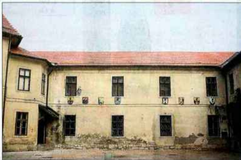
Gradu so tokrat nadeli oziroma popravili streho, v prihodnje naj bi ga tudi oblekli.
