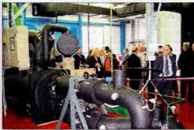
V strojnici nove hladilne centrale za potrebe družb Iskre na Laborah.
