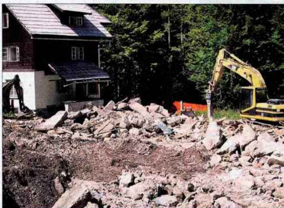
V Planici so te dni podrli star Dom in začeli z adaptacijo depandanse.
