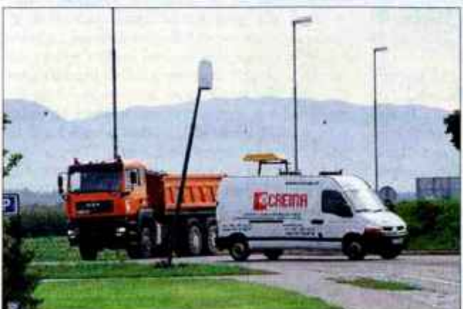
Podobna nesreča, kot se je v petek pripetila na krožišču pri Šenčurju, se je očitno zgodila tudi v krožišču ob nakupovalnem centru Mercator na Primskovem. Tam je še včeraj takole visel drog javne razsvetljave.
