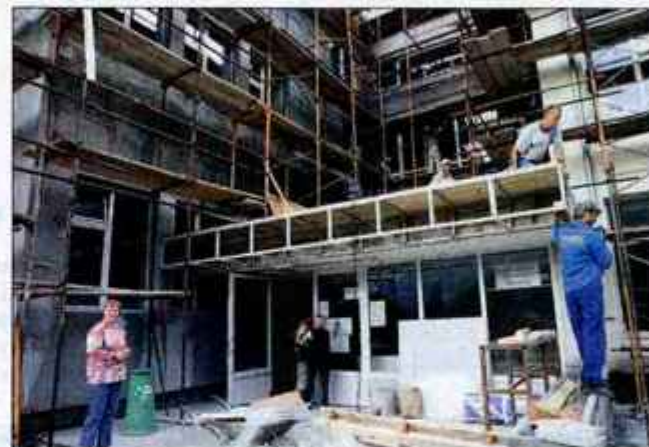
Nekatere šole, med njimi tudi preddvorska (na sliki), bodo začetek pouka dočakale z gradbiščem. Foto: Gorazd Kavčič
