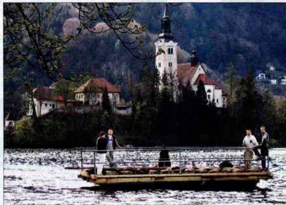
Poleg vsega gradbenega materiala so na splavu odpeljali in pripeljali tudi več kot 700 elementov stopnic.
