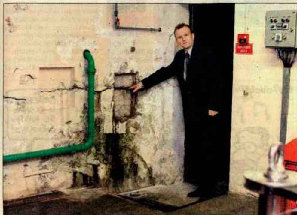
Vodja HE Moste kaže razpoke v strojnici sedanje elektrarne, ki jih povzročata pritisk neustavljenih plazov.
