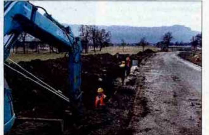
Do spomladi bodo v Hlebcah in delu Hraša zgradili kanalizacijsko omrežje in ga priključili na glavni kanal.
