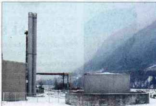
Decembra je začela delovati nova nadomestna kotlovnica za daljinsko ogrevanje Jesenic, ki bo prispevala k zmanjšanju toplotnih izgub.
