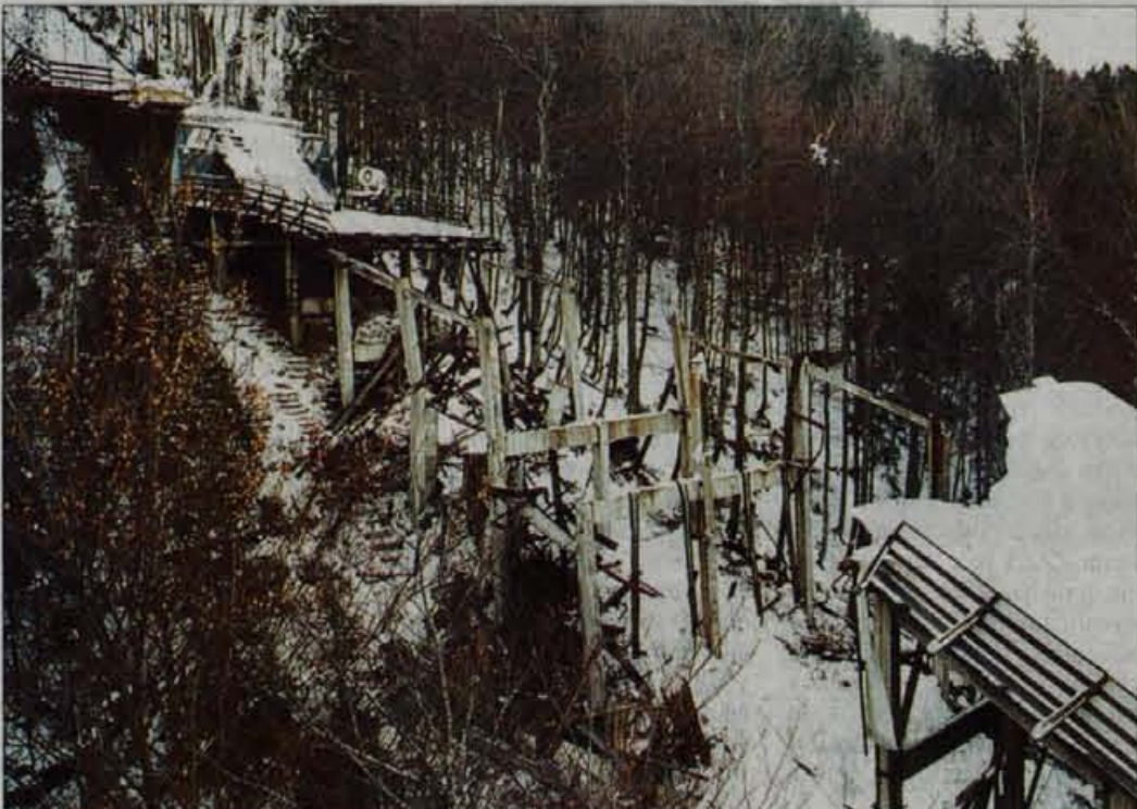
Planiška skakalnica se je porušila pred dvema letoma, zdaj jo bodo po zaslugi kranjskogorskega župana začeli obnavljati. Obnovili bodo toliko, kot je denarja: le ruševine. Foto: Gorazd Kavčič
