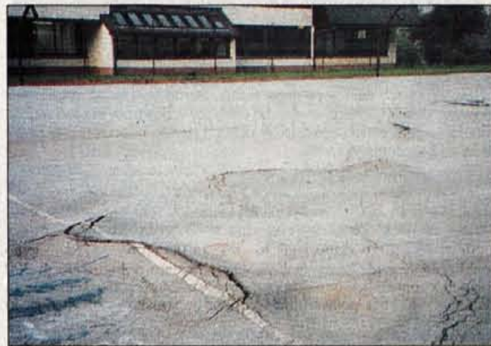
Zunanje igrišče pri osnovni šoli Koroška Bela je neuporabno, saj ga je vgrajena žlindra, ki se dviguje na vseh koncih in krajih, preveč poškodovano. Foto: D. Sedej
