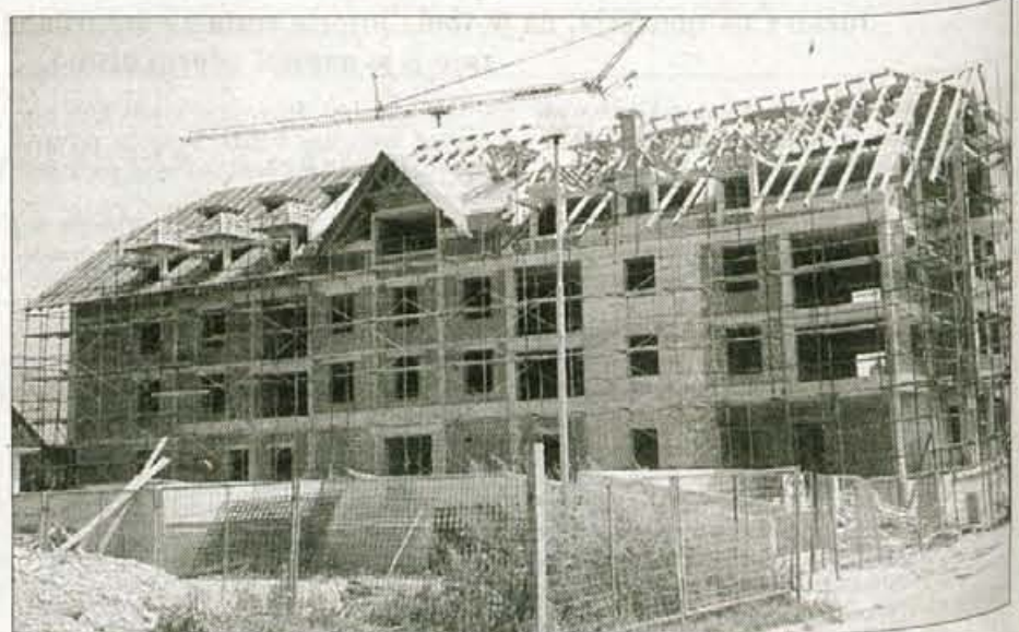
Šenčurski blok s 23 neprofitnimi stanovanji bo kmalu pod streho, dokončan pa bo v prvi polovici prihodnjega leta.
