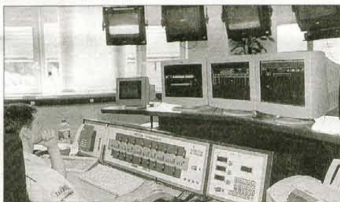
Nadzorna centrala na Hrušici, ki je v celoti računalniško opremljena; nadzor poteka izmenično z avstrijsko centralo Zauchen; ko vodijo predor na Hrušici, so na avstrijski strani v rezervi oziroma 24-urni pripravljenosti in obratno.
