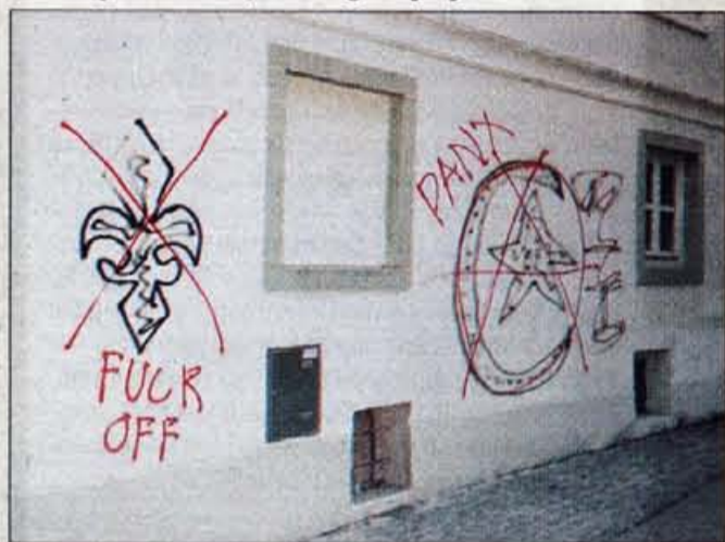
Posledica vandalskega izživljanja na radovljiški hiši ob grajskem parku.
