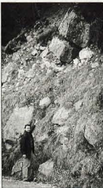
Anton Kalan kaže nezavarovano skalno brežino, ki ogroža cesto in hiše ter počitniške hišice pod njo.
