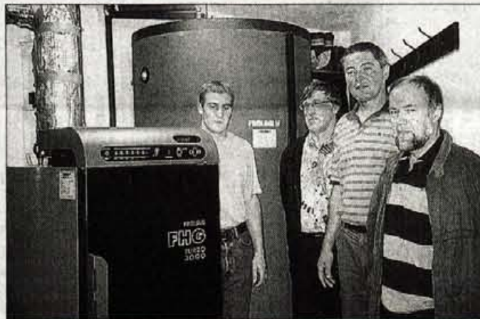
V Turkovi kotlovnici s sodobnim kotlom na polena in s hranilnikom toplote.
