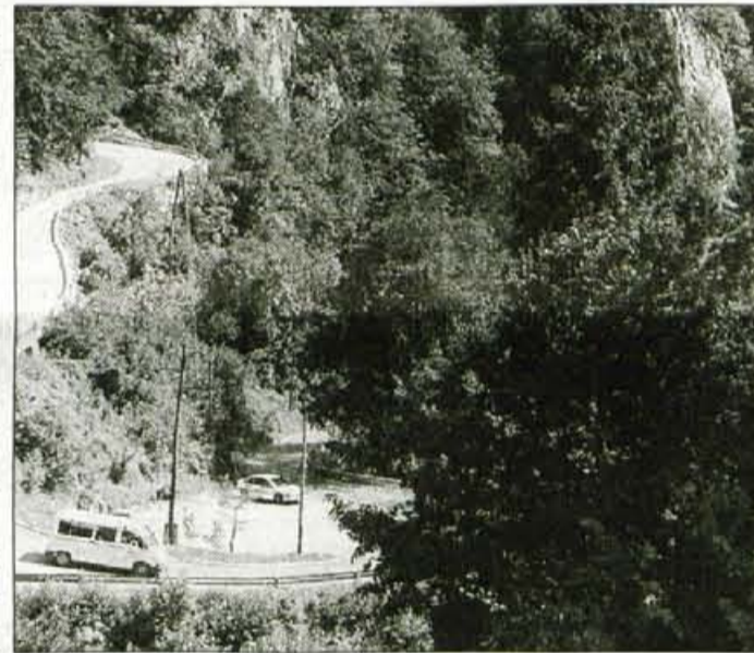
V serpentinah nad predorom je vse več razpok na cestišču.
