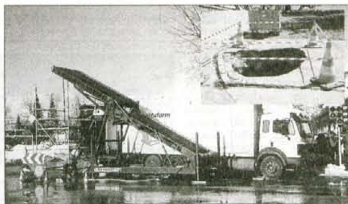
Primer podora zaradi poskodovane kanalizacije na Kebetovi ulici in nova metoda obnove.
