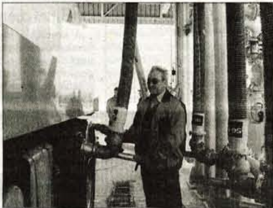
Največ posodobitev je bila deležna avtopolnilnica: v avtocisterne, ki prevažajo goriva do bencinskih servisov, goriva pretankajo iz rezervoarjev prek zaprtega sistema, hlapi pa so speljani po posebnih ceveh v sistem za utekočinjenje.
