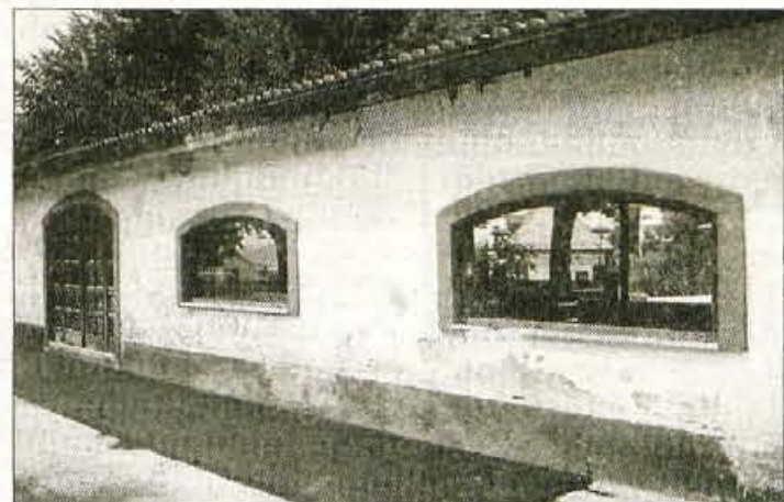
"Utrujeno" pročelje s pogledom na vrt.
