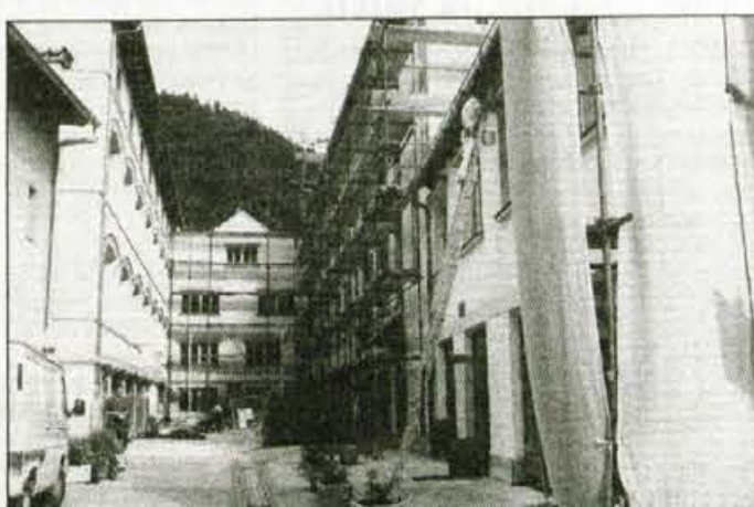
Na fasadi občinske stavbe končujejo obnovitvena dela, saj bo že prihodnji petek v atriju koncert Slovenskega okteta na letošnjih Poletnih prireditvah v Trziču.
