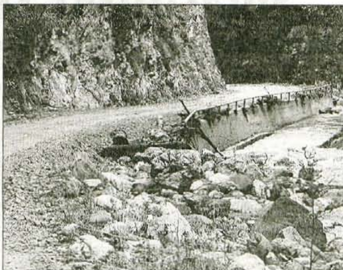
Cesto v Davčo je povsod tam, kjer ni bila urejena brežina, precej poškodovano. Začasno nasutje omogoča le osebni prevoz.
